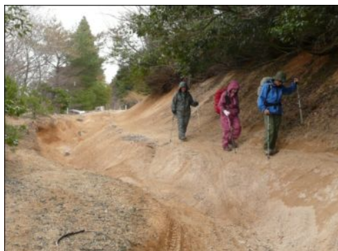
崩壊した林道 15:19
